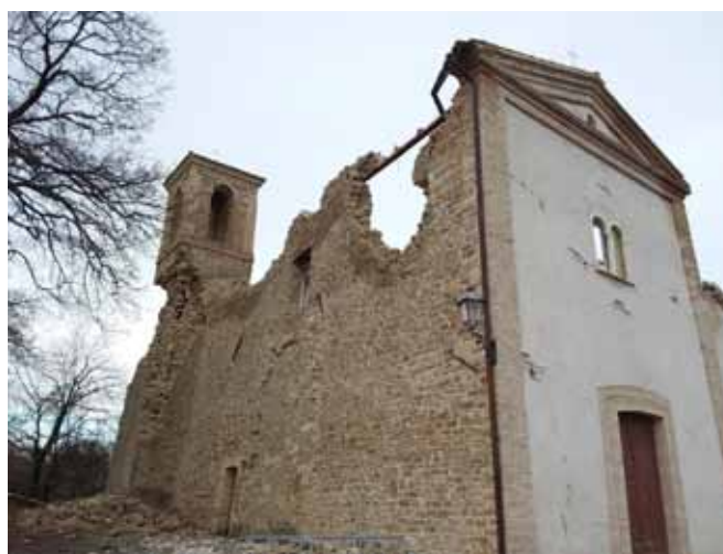
Chiese di Pievebovigliana distrutte durante il terremoto
